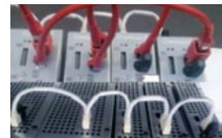
3-Achs-Steuerung im Anleger
